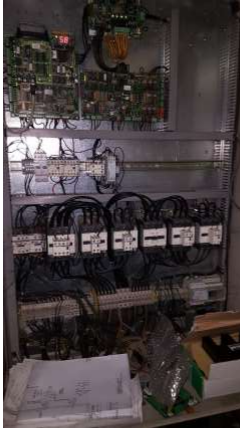
Armoire de manœuvre.
