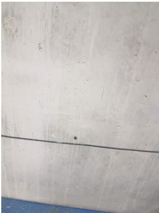
Câble électrique sur paroi lisse.
